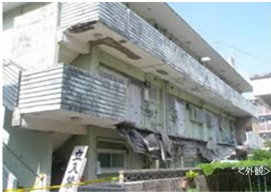
マンションの2階廊下部分が崩落した事例
