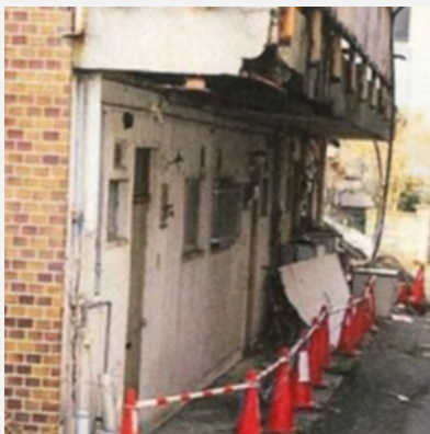
外壁剥落等の危険な状態
